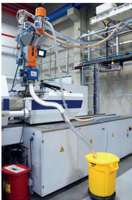
Bild 5: Die Dosiereinheit auf der Spritzgießmaschine in Kombination mit einem Metallabscheider (blaue Zwischenstation zwischen Maschine und Dosiergerät) (Foto: Reinhard Bauer)
